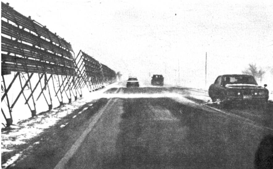
شکل ۳-۴- حصار برف‌زدکن چند رشته که در شانه راه نصب شده است.
